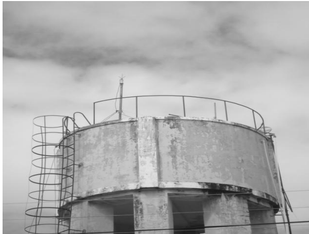
Figura 6 - SPDA tipo Franklin Caixa d'água PROGRAD
